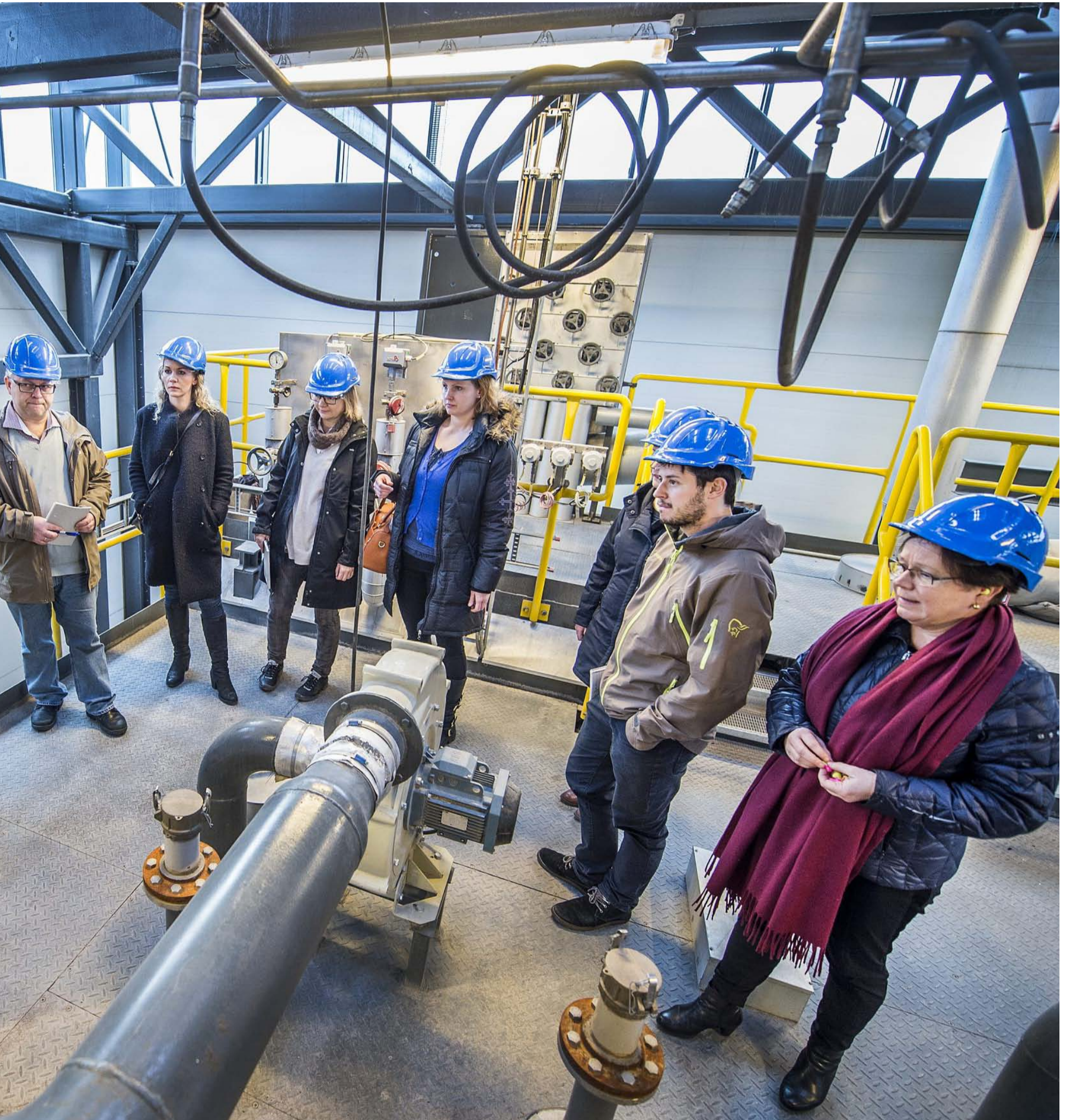
Møreforsking i samarbeid om bruk av overskuddsvarme. Her er aktørene på omvisning på Grautneset. Fra v. Knut Arne Tafjord, Tafjord Kraftvarme, Annelise Chapman, Barneng Trygg, Margrete Emblemsvåg, Pierrick Stévant, Møreforsking, og Anne-Berit Salen Tafjord Kraftvarme.
